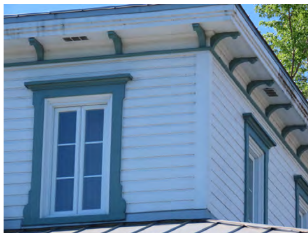
Planche à feuillure sur le presbytère de Saint-Georges. 1890, 1 re Avenue-Clermont-Pépin, Saint-Georges. Img_3424-C.jpg
