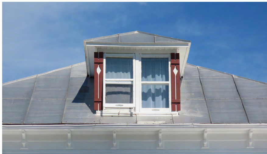
Bel exemple de tôle pincée au 300, rue Principale, Saint-Evariste-de-Forsyth. IMG_4496L.jpg
